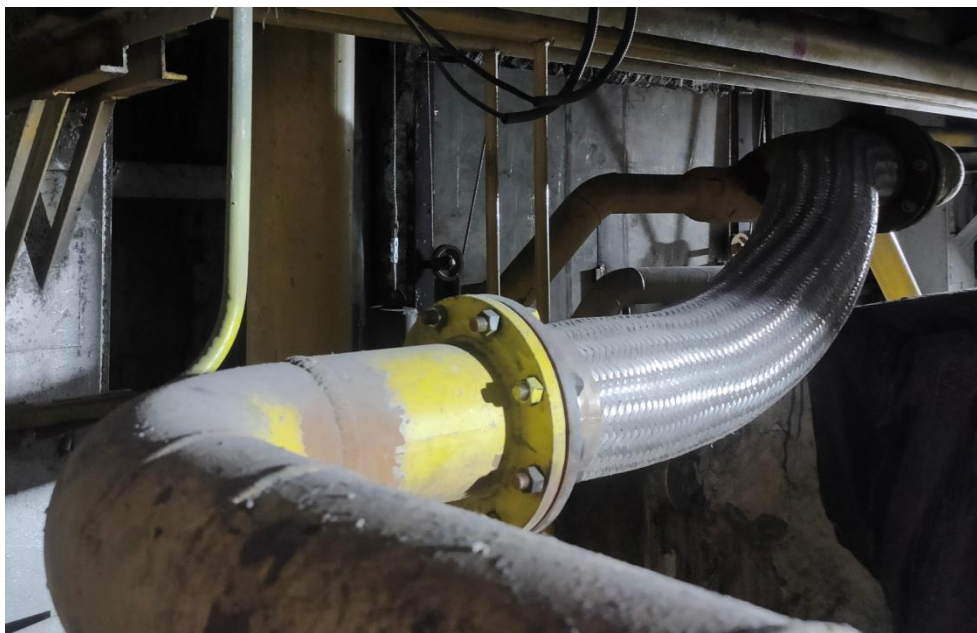
Рисунок 3.7.1 – Металлорукав между подводящим газопроводом и газовым коллектором горелки
