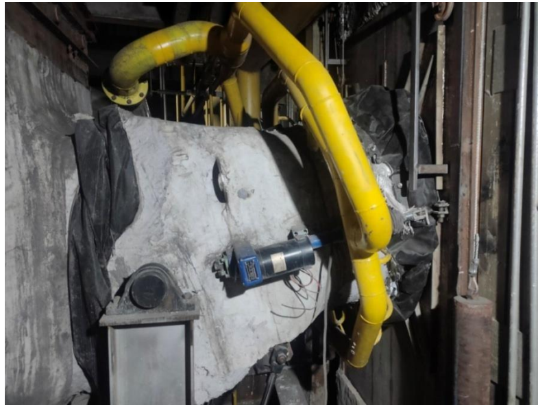
Рисунок 4.2.3 – Поворот горелки на холодном котле на +15^\circ , вид снаружи топки
