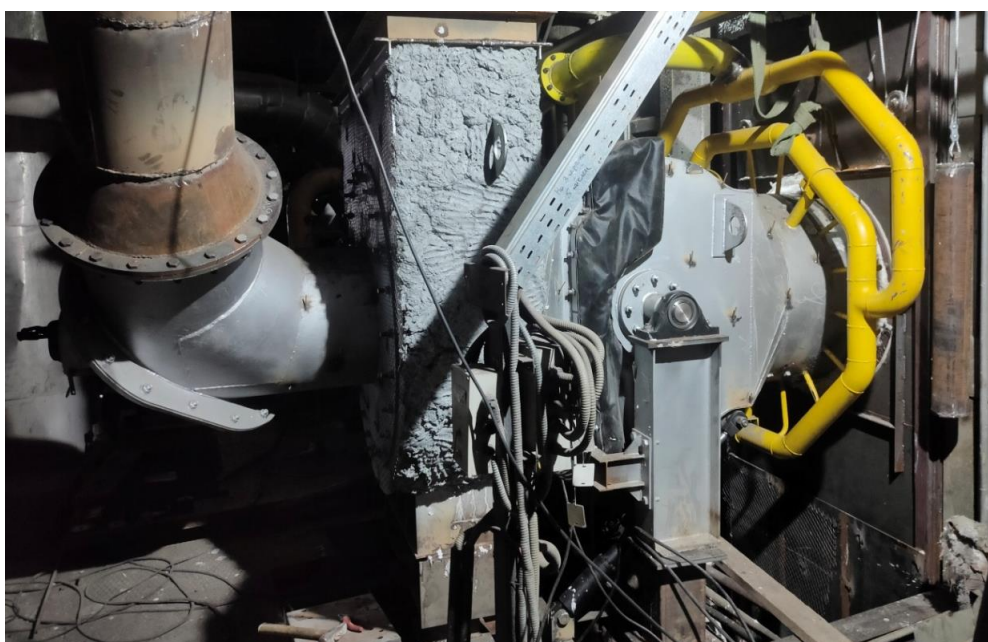
Рисунок П5.2 – Поворотная горелка, установленная на котле БКЗ-210-140
