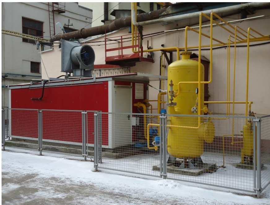
Дожимная компрессорная станция
