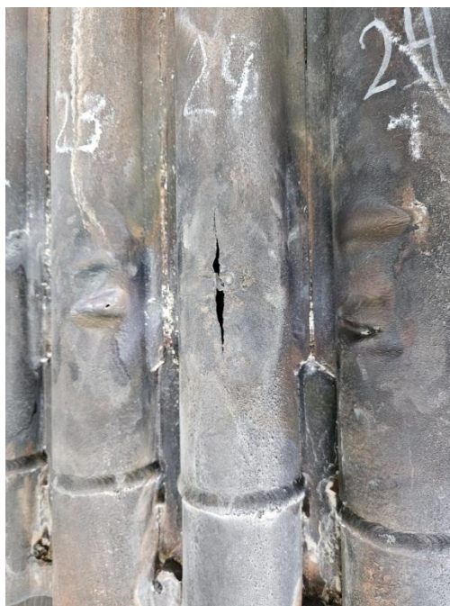
Рисунок 7. Характер повреждения трубы № 24 солевого отсека котла ТПЕ-131
