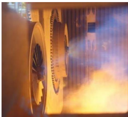
Котел Е-210 (210 т/ч), 4-е горелки Zeeco FJ по 40 МВт NO x = 60 мг/м 3 без ДРГ и третичного дутья.
