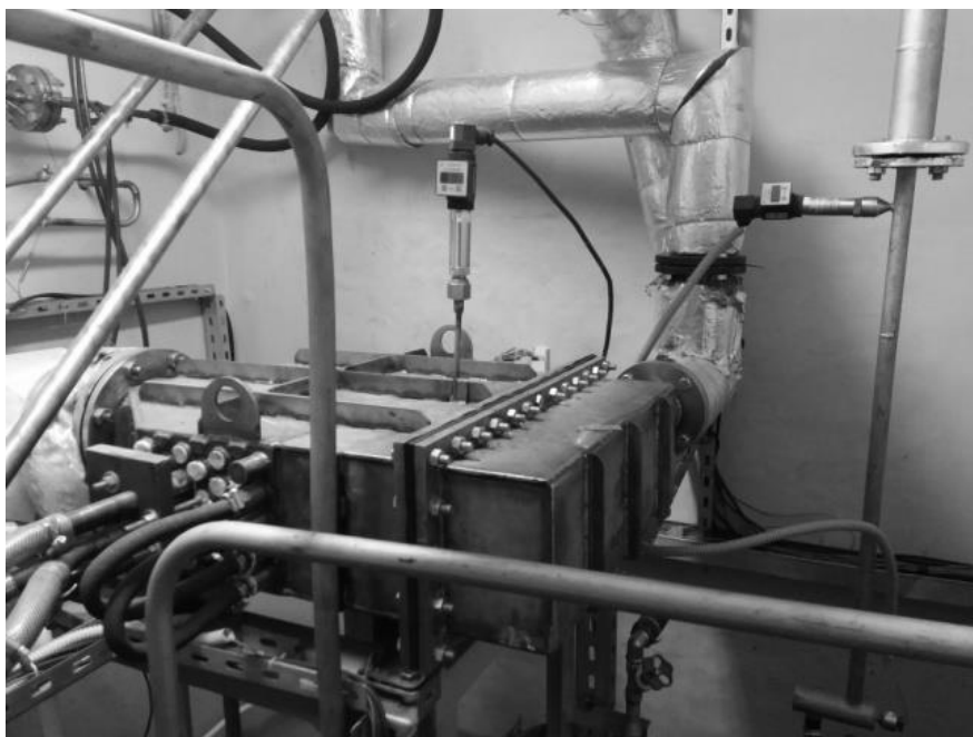
Рисунок 13 – Общий вид рабочего участка на стенде
