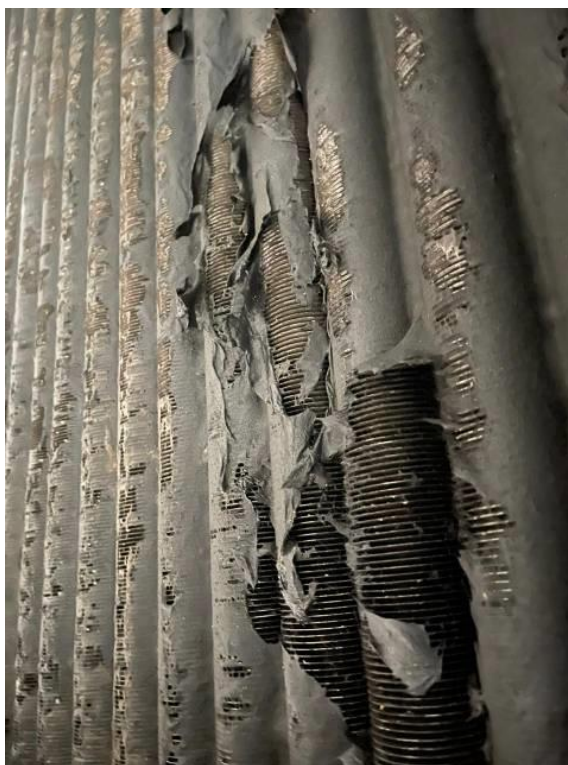
Рис. 2.2. Загрязнение теплообменных труб со стороны входа воздуха
