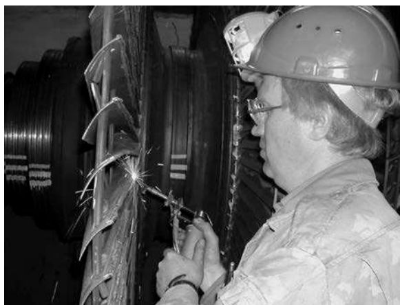
Рис. 3. Нанесение металлатором защитных покрытий на лопатки 30-й ступени при ремонте турбины ПТ-80-130/30 ЛМЗ АО «Кишиневская ТЭЦ-2» (ст. № 1) при расположении ротора на козлах ремонтной площадки
