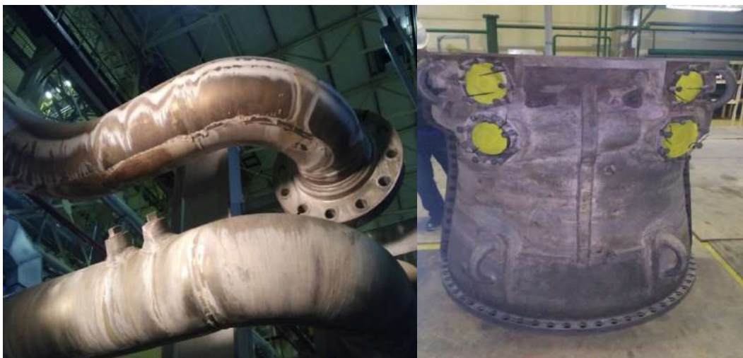
Рис. 1. Накипь на трубопроводах и корпусе компрессора
