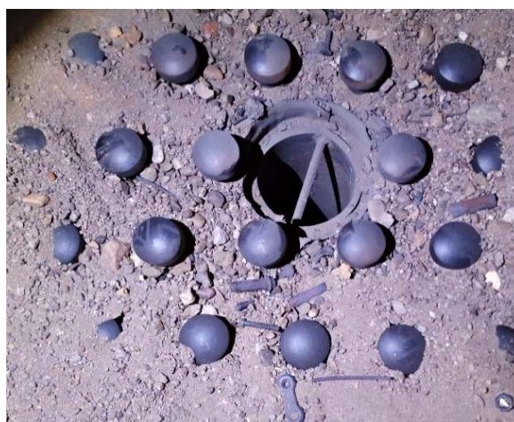
Рис. 7. Посторонние включения среди шлака на поде топки рядом с трубой сброса шлака в шлакоохладитель
