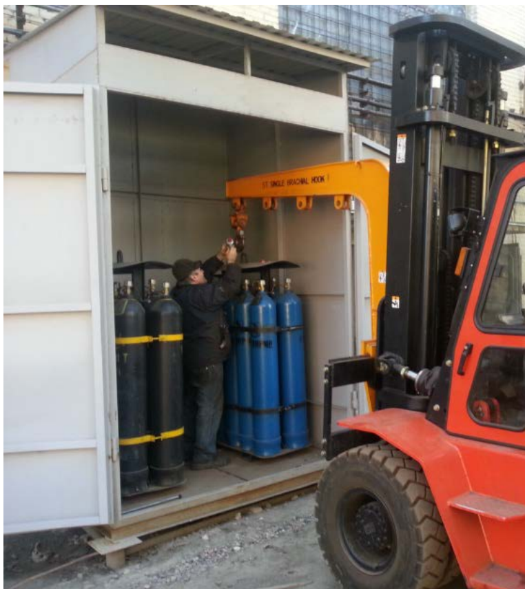
Шкаф газоразрядных рамп (азот и кислород)
