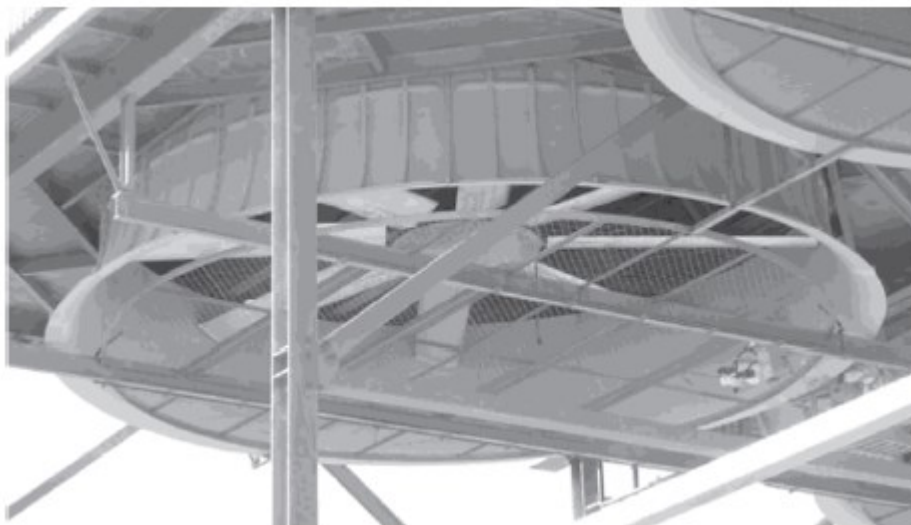
Рисунок 1.9. Вентилятор воздушно-конденсационной установки с колесом диаметром 10 метров [66]
