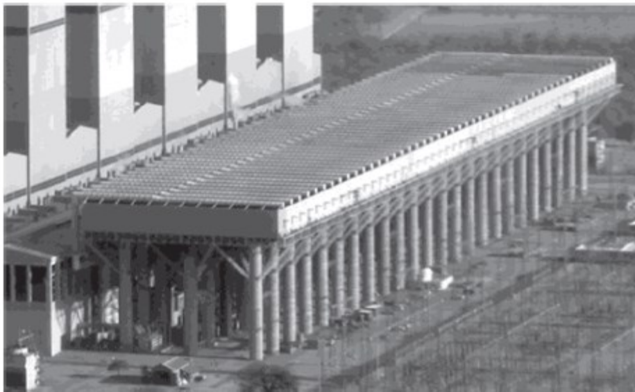
Рисунок 1.5. Воздушно-конденсационная установка электростанции Matimba (ЮАР) общей мощностью 3990 МВт [63]
