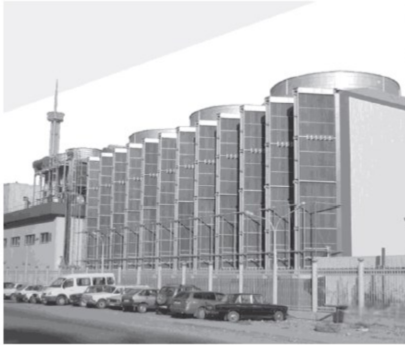
Рисунок 1.4. Сухая градирня для паровой турбины в составе ПГУ мощностью 220 МВт Сочинской ТЭЦ (Россия) [63]
