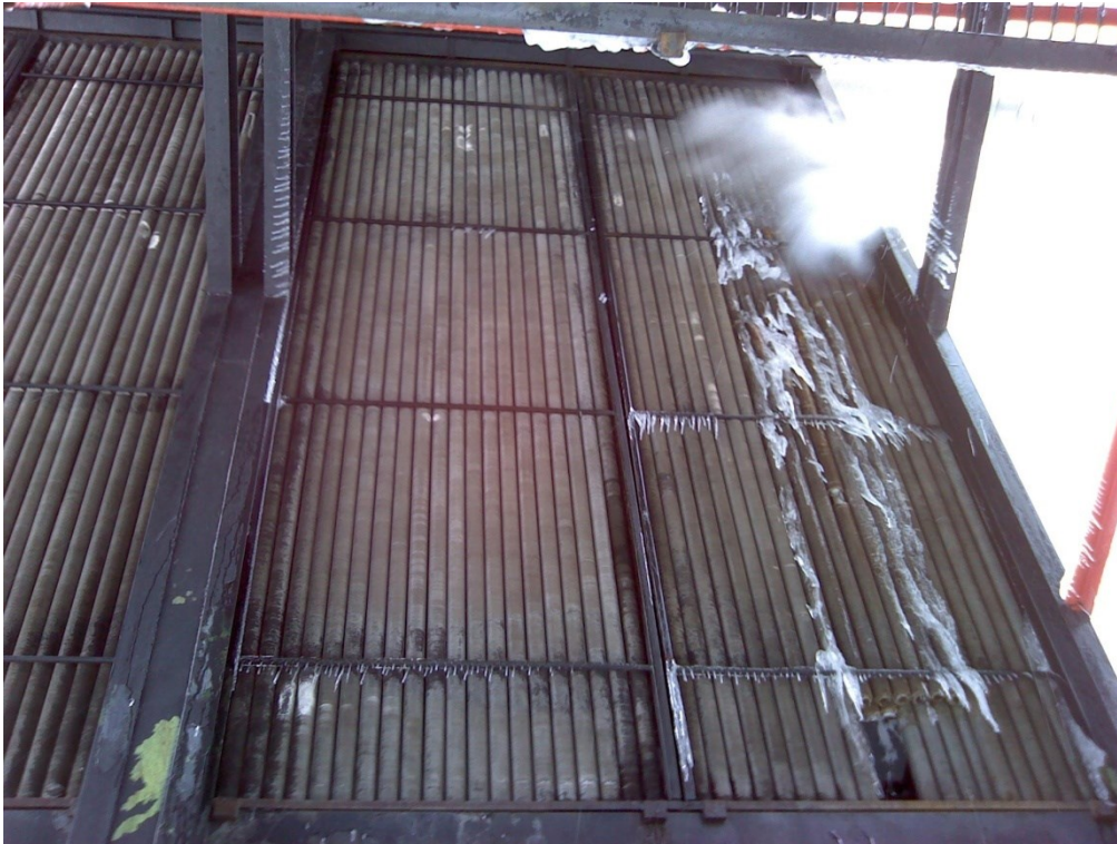
Рисунок 1.13. Фотография разрушения одноходового конденсатора, в котором разморожен первый по ходу воздуха ряд трубок (фото автора)
