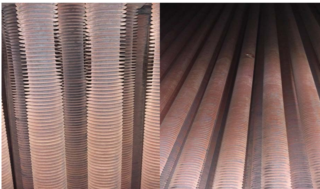
Рис. 3. Поверхности нагрева котла-утилизатора П-143
