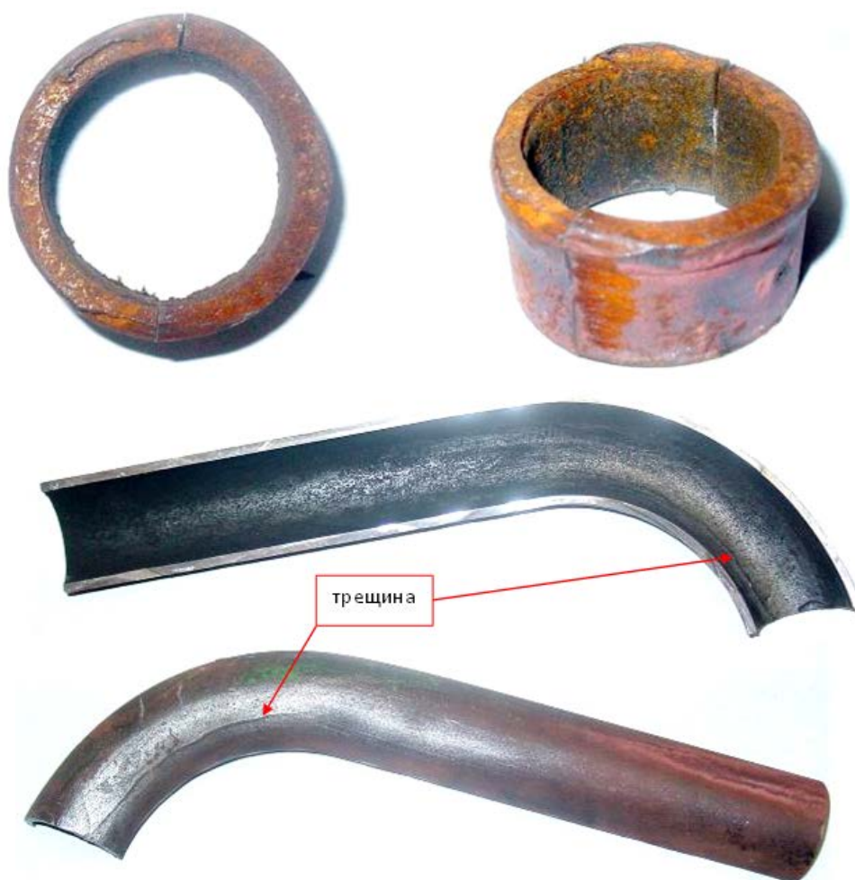
Рис. 5. Общий вид поврежденных гибов трубы из стали 12Х1МФ
