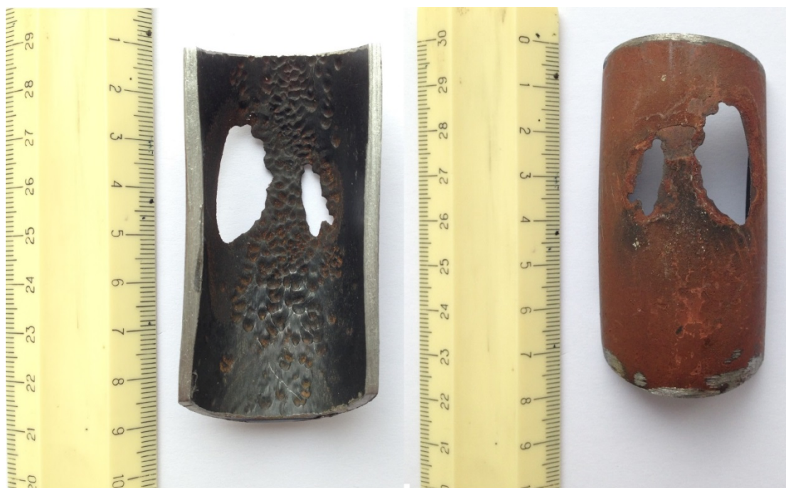
Рис. 1. Повреждение трубыгиба испарителя ИНД котла-утилизатора вертикального типа.
