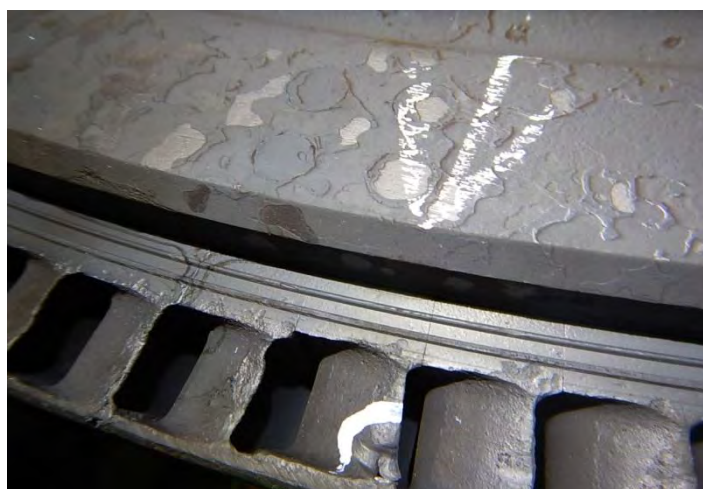
Рис. 3. Исходное состояние входных кромок рабочих лопаток 1-го венца регулирующей ступени турбины Т-100/120-130. Общий вид, забоина отмечена маркером
