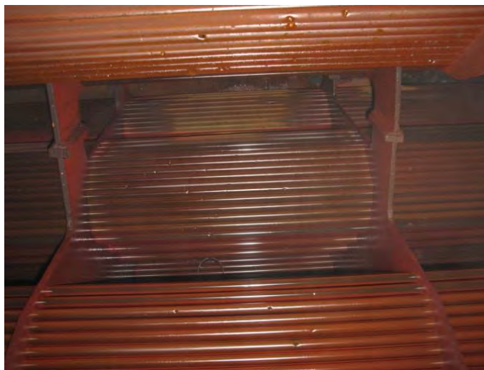
Рис. 4. Общий вид из секций конденсаторных трубок охлаждения с повреждениями от оторвавшихся стеллитовых пластин
