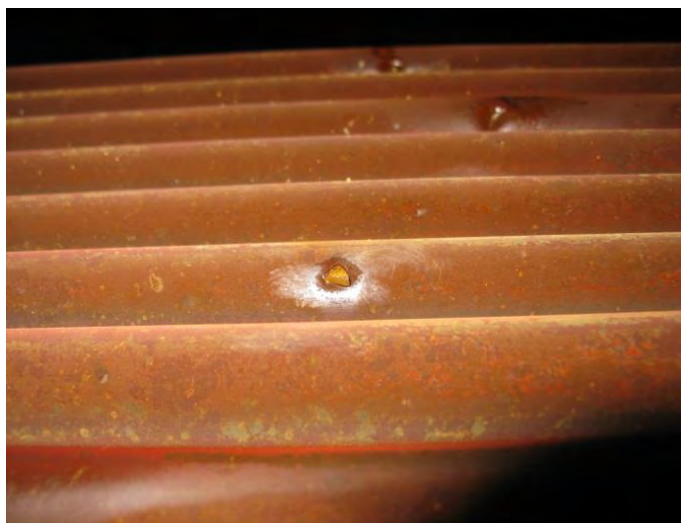
Рис. 3. Повреждения конденсаторных трубок оторванными титановыми пластинами (на переднем плане повреждение трубки охлаждения с застрявшей в материале трубки пластины ВЗК)
