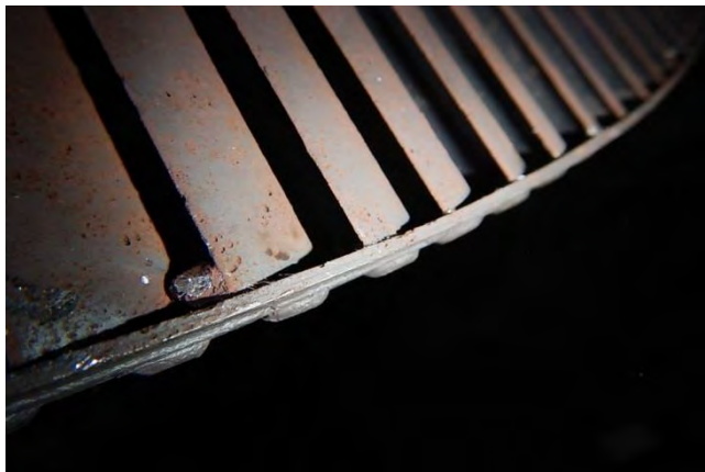
Рис. 1. Сварочный грат, застрявший между лопатками
